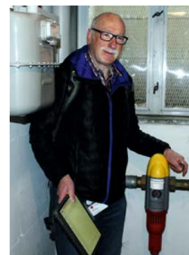
Bernd Sagurna kontrolliert und leert den Rückspülfilter der Trinkwasseranlage eines Mehrfamilienhauses.
